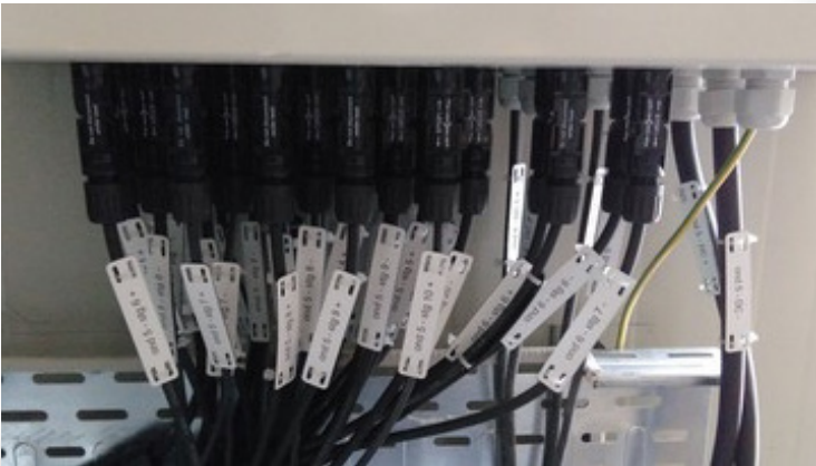
Signalétique sur le coffret DC, chaque câble est identifié en fonction de son onduleur et de son string
